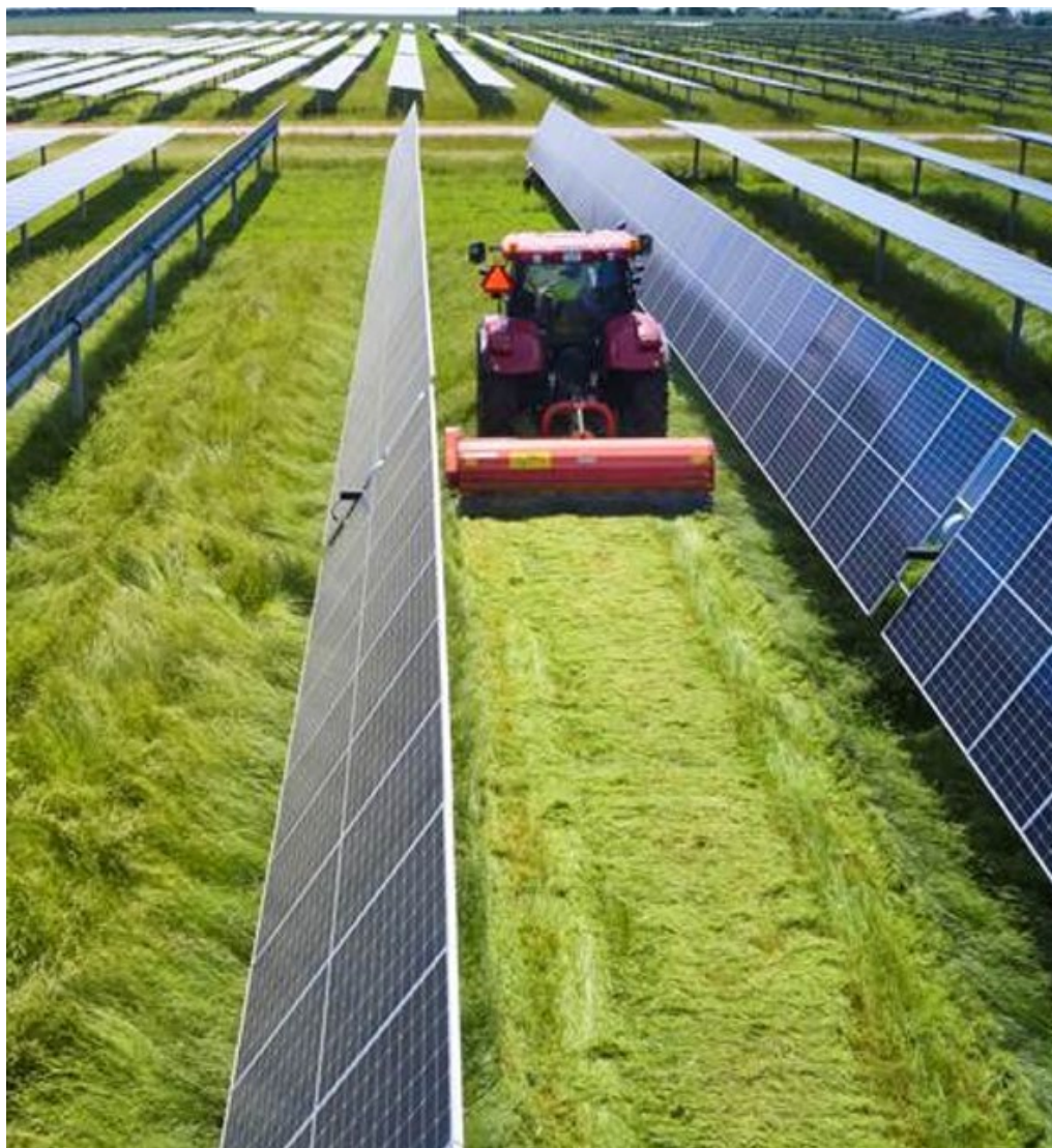
Figur 3-10 Solcellepaneler på tracker-stativer.
