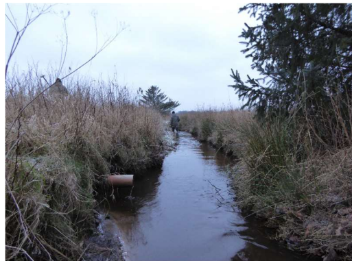
Station 5539. drænudløb 57 cm over bund
